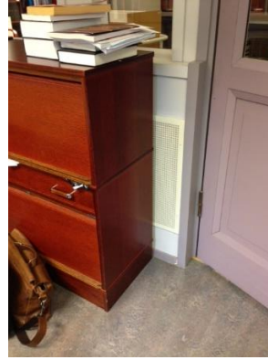
Bilde 2: Eksempel på tildekket tilluftsventil (K077).
